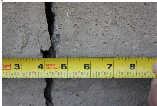
(d) wide crack opening
