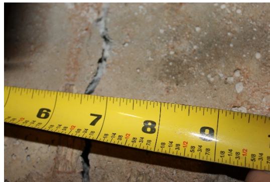
(d) wide crack opening
