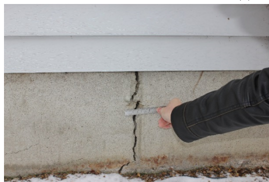
(d) wide crack opening
