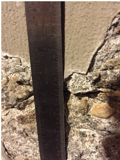
(d) wide crack opening
